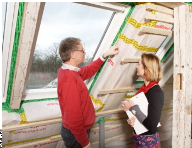
Foto: VPB Mit einer umfassenden Dämmung können Hauseigentümer rund zwei Drittel des Heizenergiebedarfs einsparen. Zudem reduziert sich die Schimmelgefahr.
